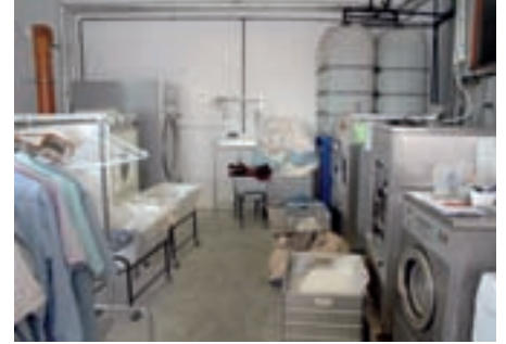
Der Nassreinigungsbereich in der Norge-Textilreinigung.
